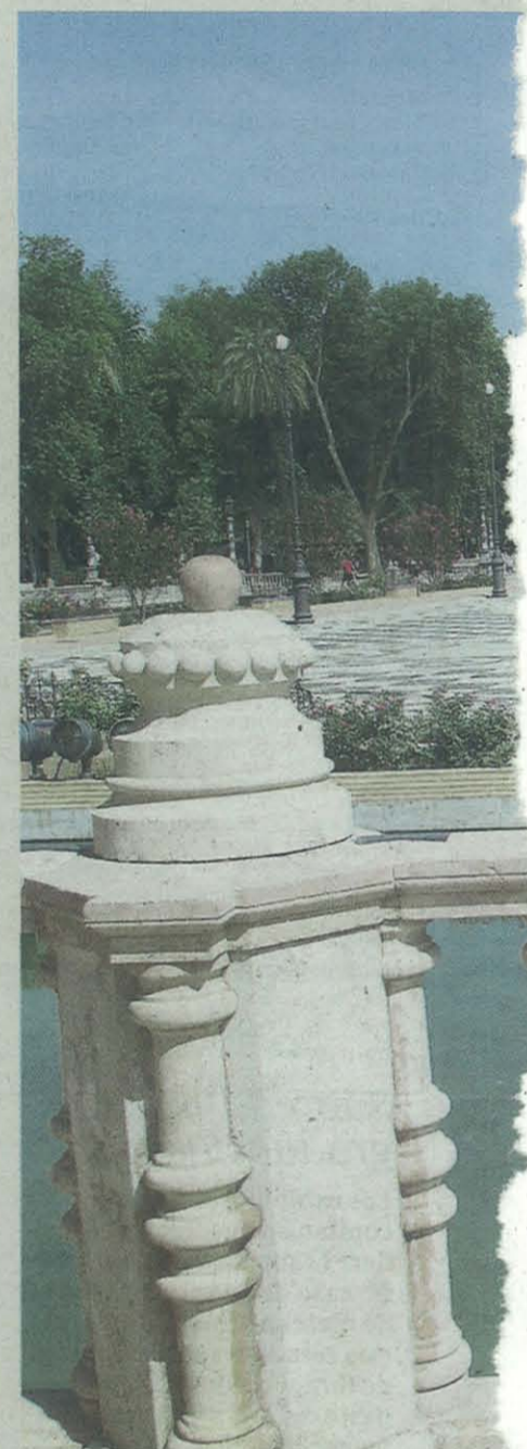
En la balaustrada de la Plaza de España falta una pieza, como se muestra en la imagen, desde hace más de un año
